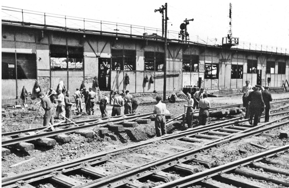
Italienische Militärinternierte arbeiten am Hannoverschen Bahnhof in Hamburg, Juli 1944. (Eisenbahnstiftung, Fotograf: Walter Hollnagel)
